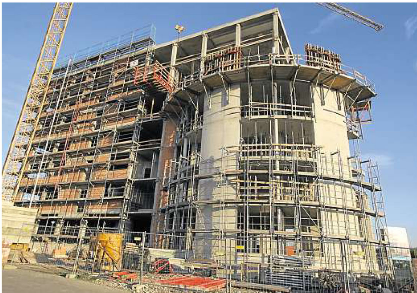
Im Rekordtempo wächst das „Vitanum“ dort in die Höhe, wo früher das Verwaltungsgebäude von Kümmerling stand.
